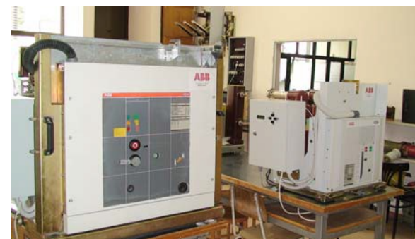
Laboratorul de Echipamente Electrice
